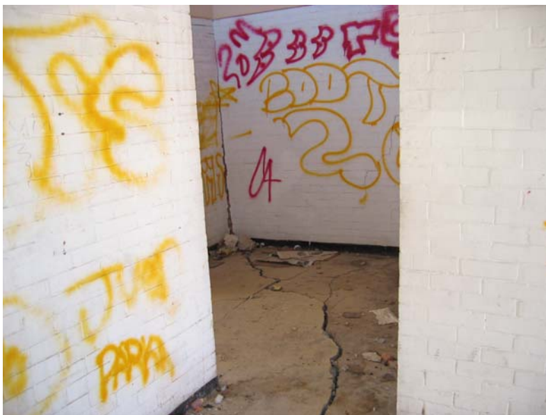
Foto 1. Daños irreparables a casas habitación, en el piso se observa la grieta producida, por extracción de agua, ciudad de Aguascalientes México (tomada por el primer autor)
