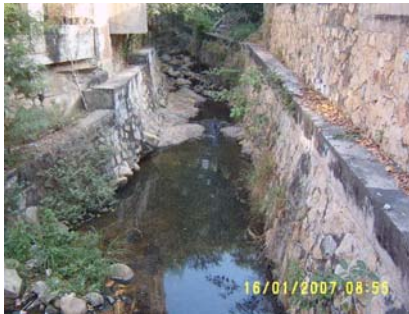
Figura 7. Socavación muros de protección
