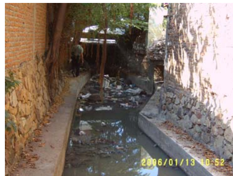
Figura 4. Vertimiento de aguas residuales
